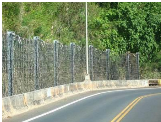
图 3-22 被动防护网防护
