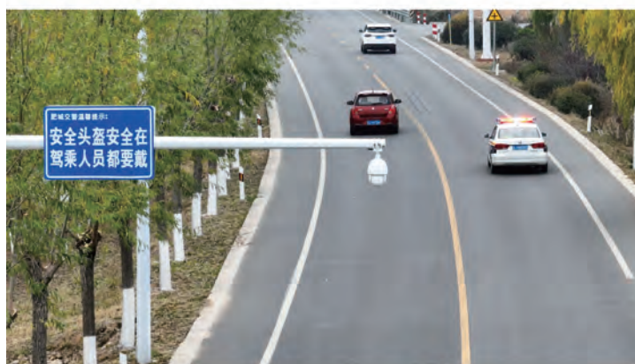
图5 道路监控系统
