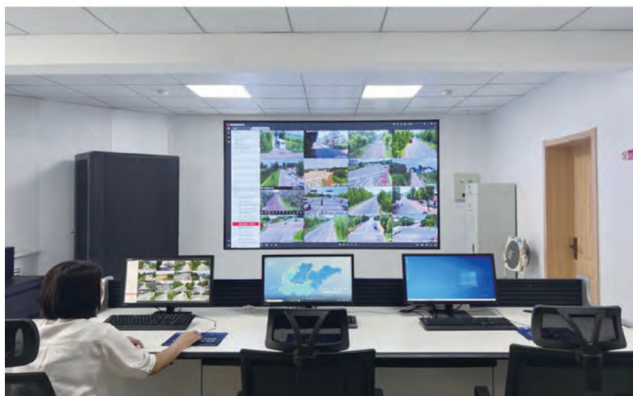
图1 齐河县农村公路信息化大厅
