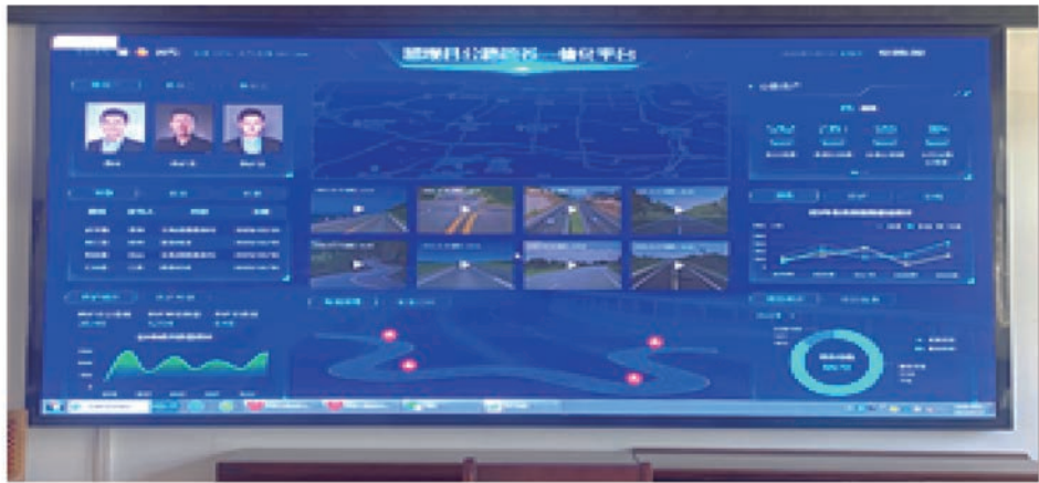
图 15 留坝县交通运输局智慧交通控制中心
