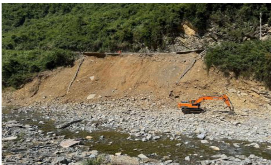
图 2 Y059 城北线 K0+800 路基修复前
