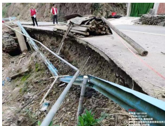
图 7 保险公司现场勘察
