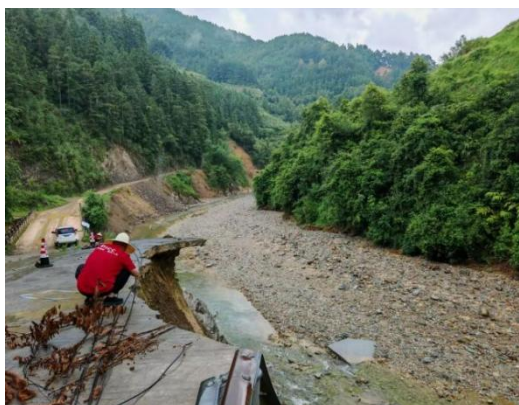
图 6 保险公司现场勘察
