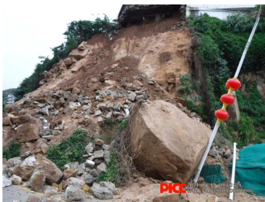
图 1 构嵯线 K2+220 修复前
