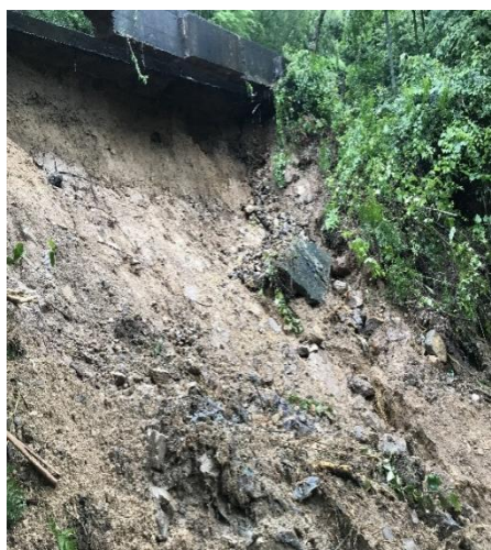
图 5 临石线 K109+200 (受损图)
